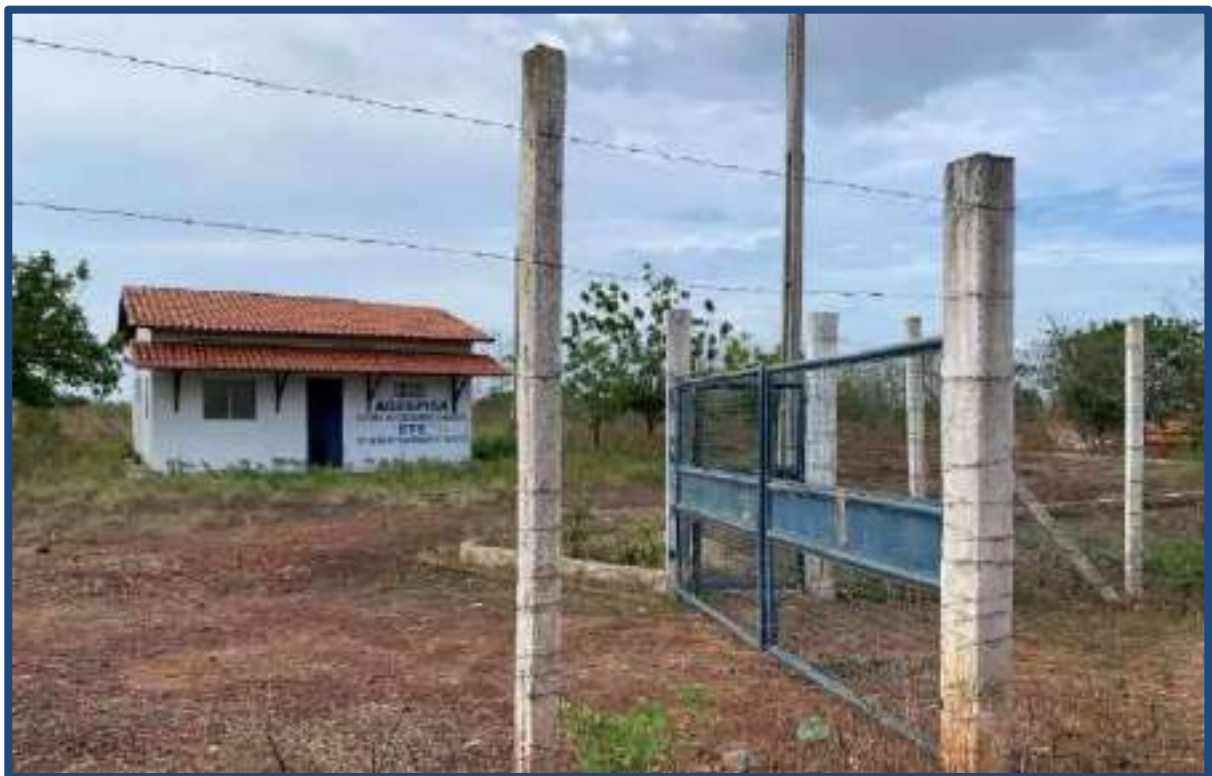
Estação Elevatória de Esgotamento Sanitário Nº 04 - Ilustração: Carlene Sales
