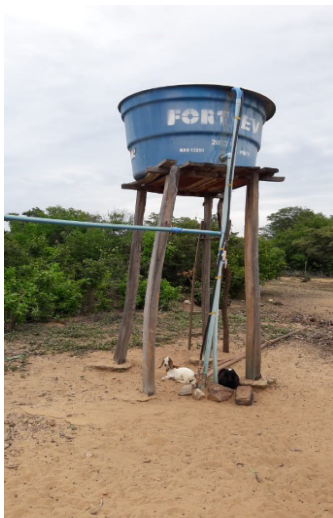
Figura 7 - Sistema fotovoltaico para bombeamento e armazenamento de água.
