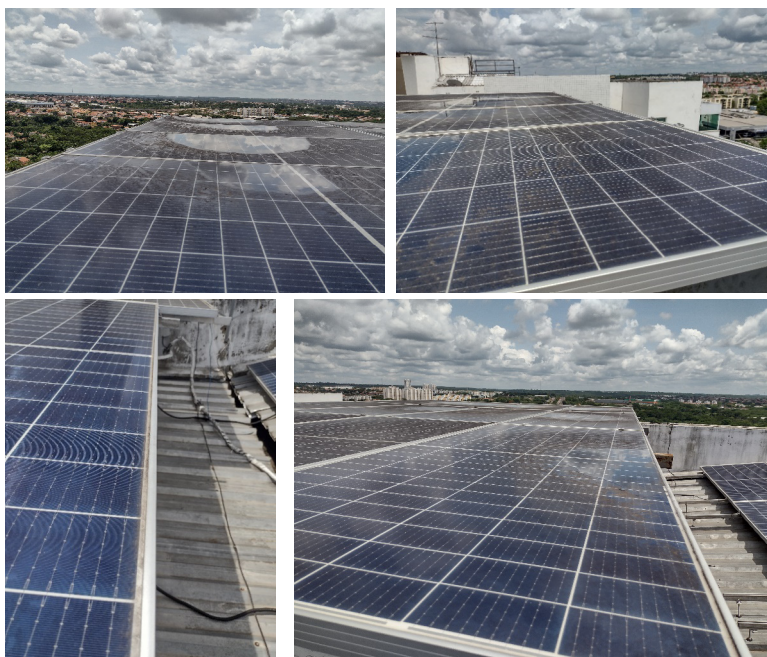
Figura 1 - Módulos antes da limpeza, com deposição de sujidade não uniforme
