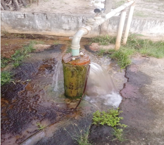
Foto - 2: Poço de água
