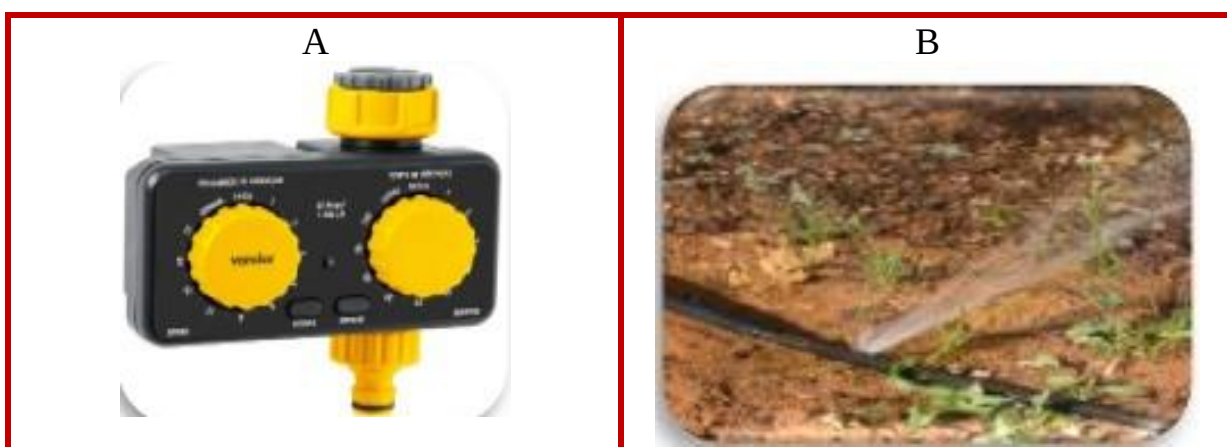
Figura 16 – A) temporizador de irrigação e B) mangueiras com vazamento.
