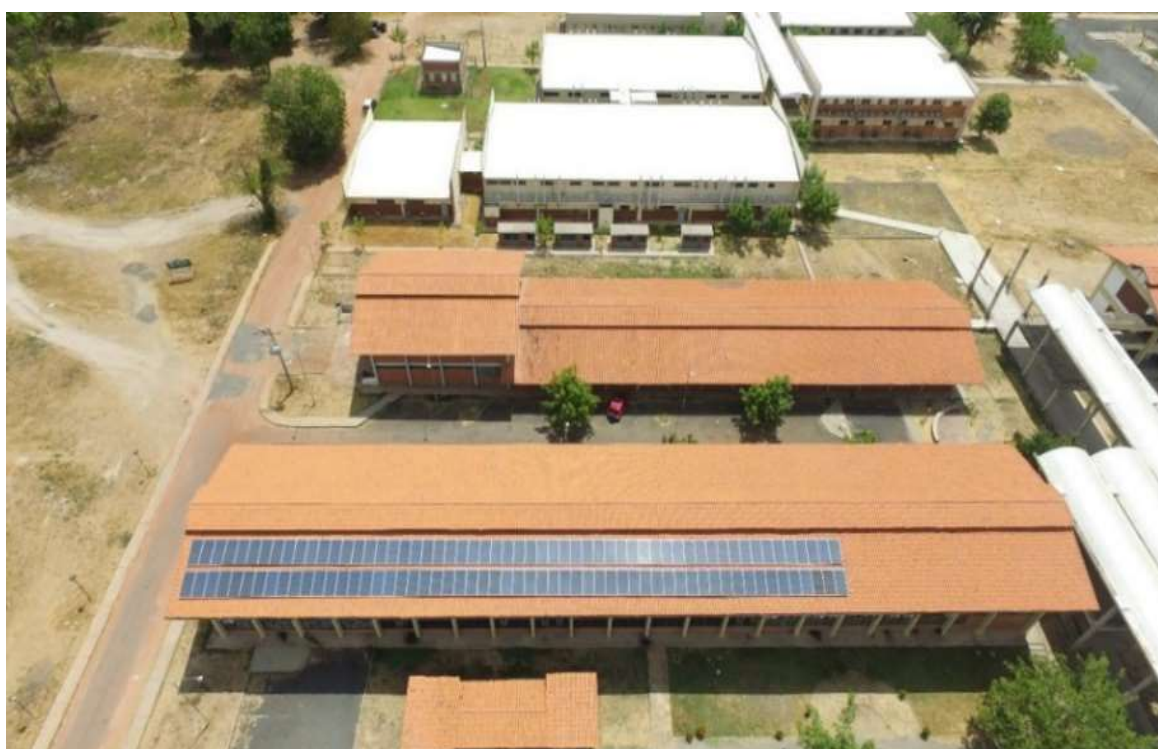
Figura 59 – SFCR instalado no Bloco 8 do CT da UFPI
