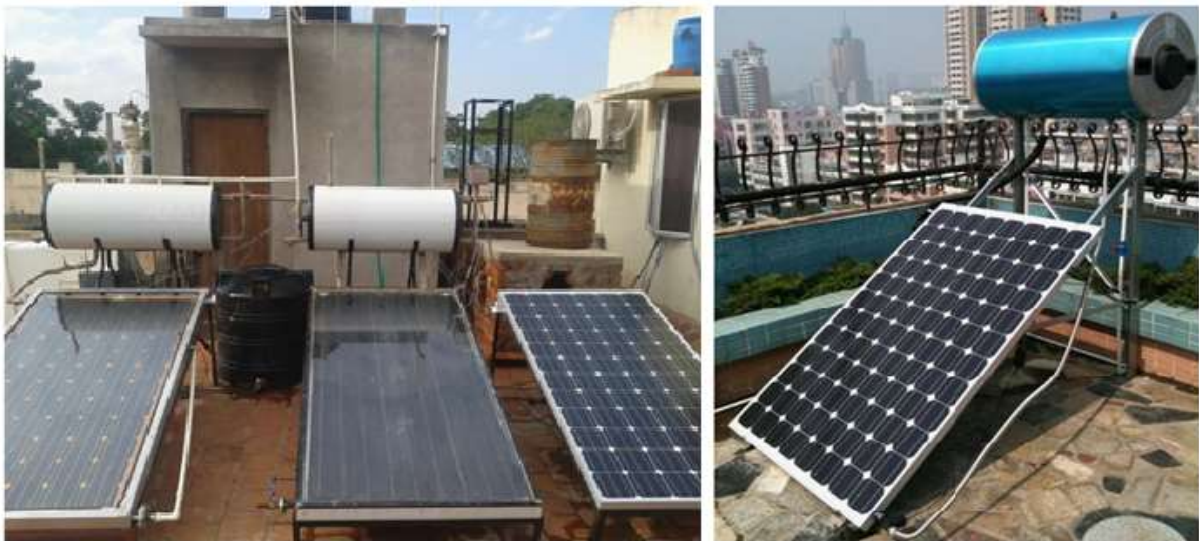
Figura 17 – Sistemas PVT para geração de energia elétrica e calor
