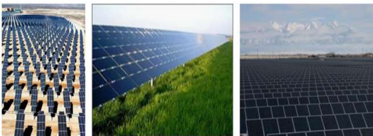
Figura 16 – Sistemas Fotovoltaicos para geração de energia elétrica
