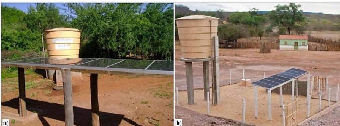
Figura 51 – Sistemas fotovoltaicos autônomos utilizados para bombeamento de água.
