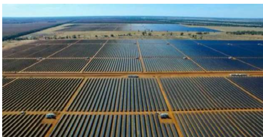
Figura 56 – Usina de Nova Olinda com 292 MWp, em Ribeira do Piauí
